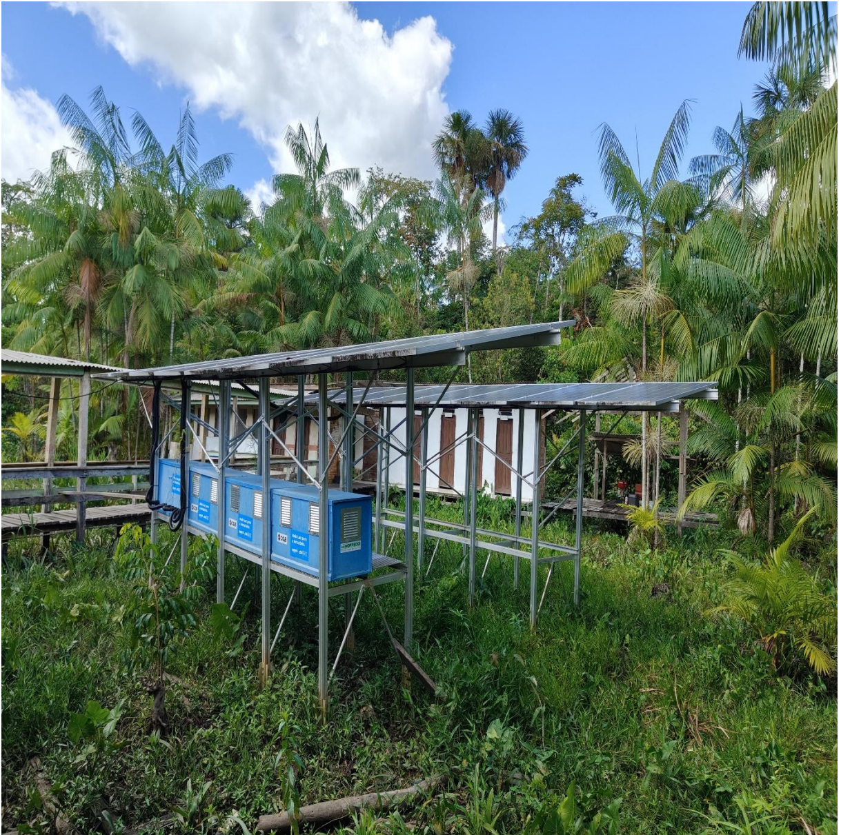
Figura 8 – Sistema de geração de energia solar da Escola Portugal.
