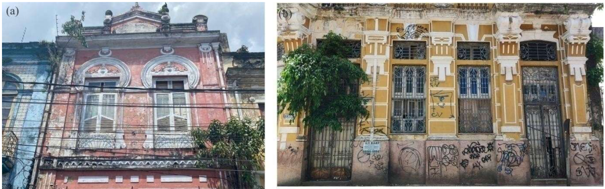
Figura 9: Imóveis em estado de degradação no Centro Histórico de Belém.
