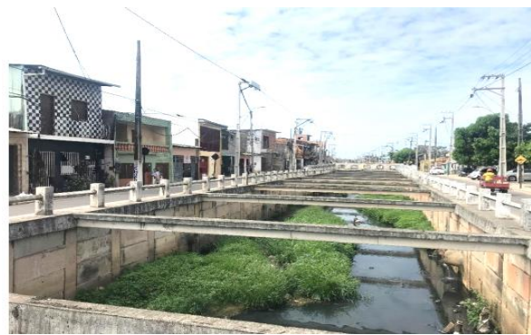
Figura 3 - Assoreamento em Canal da Bacia Hidrográfica Estrada Nova.
