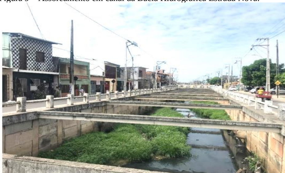
Figura 9 – Assoreamento em canal da Bacia Hidrográfica Estrada Nova.
