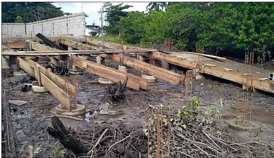
Figura 20 - Construção adentrando área de manguezal em Marapanim. Fonte: Frame de filme tirado de Do Canto (2022).
