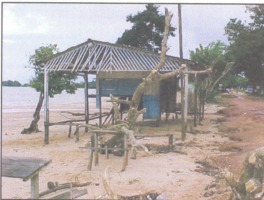
Fig.12. Barraquinha da praia totalmente destruída durante as marés de sizígia (praia do Paraíso, março de 2001).
