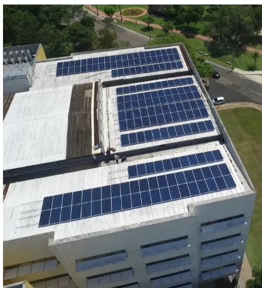
Figura 20 – Vista superior do sistema fotovoltaico do Mirante do Rio.
