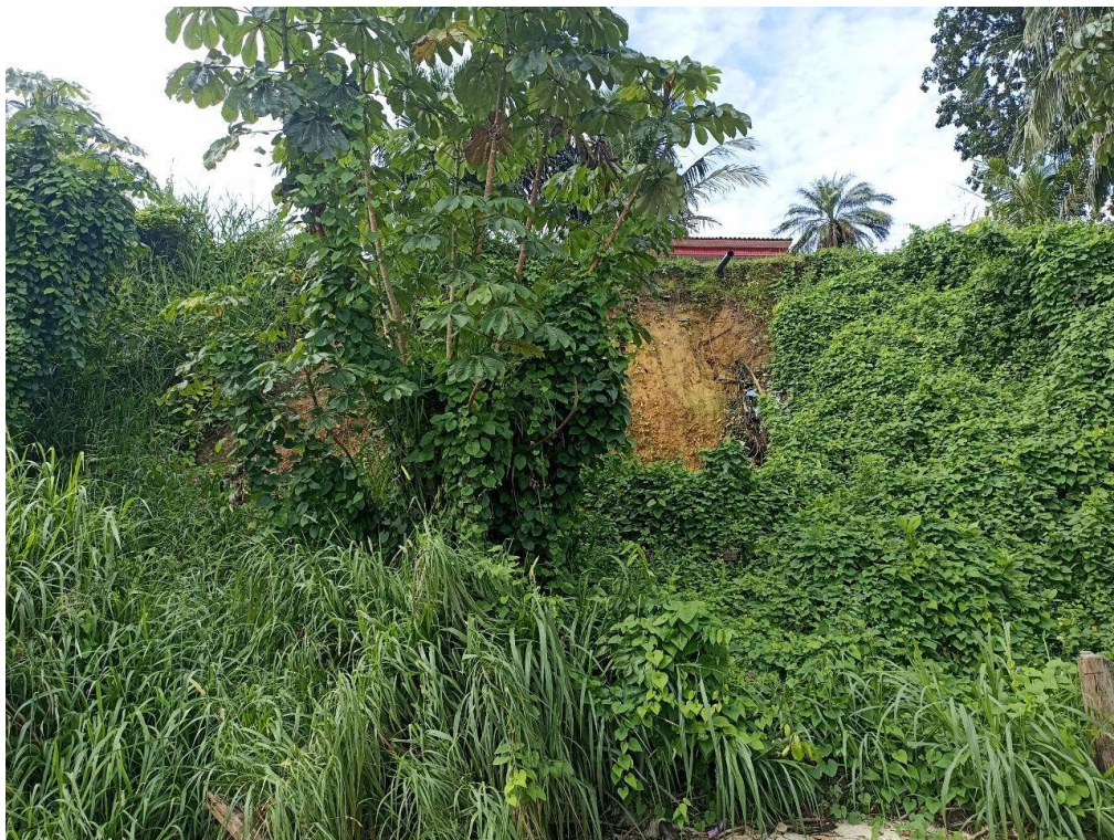
Fotografia 18 – Ponto 8: Erosão de Encosta
