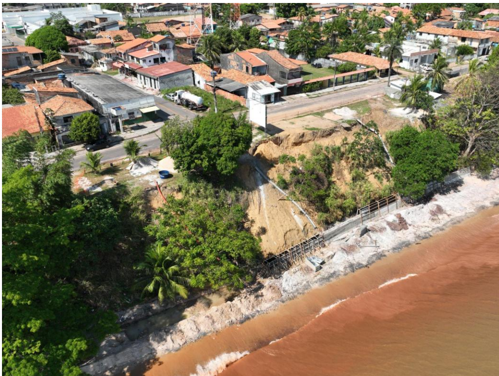
Fotografia 15 - Ponto 6: Processo erosivo e contenção em construção
