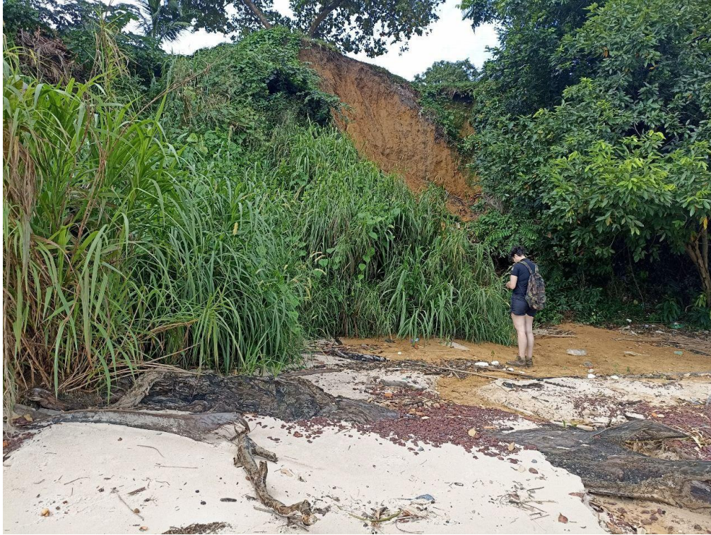
Fotografia 14 - Erosão e Escorregamento
