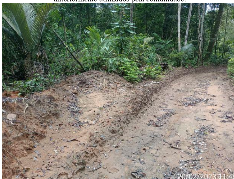
Figura 59 — Canaletas (“rasgos”) provocados ao longo da estrada da madeireira que obstruem os ramais anteriormente utilizados pela comunidade.
