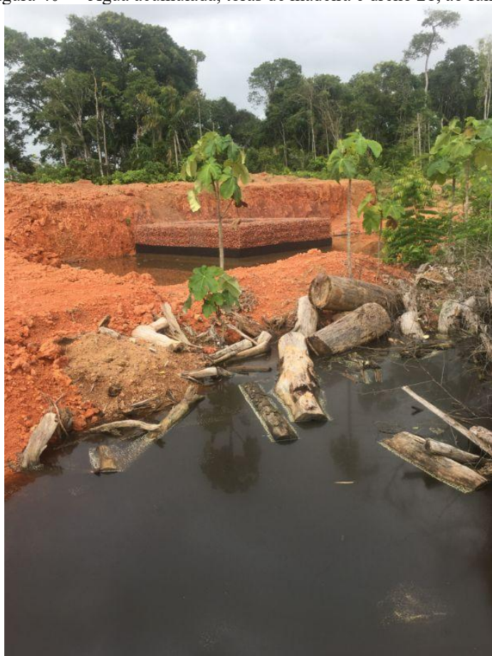
Figura 40 — Água acumulada, toras de madeira e dreno 21, ao fundo.
