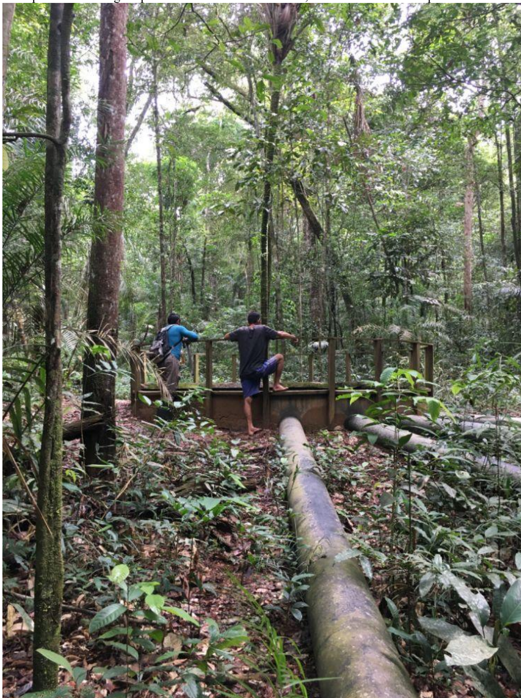
Figura 33 — Edinaldo e Vaca observam, direcionados à subida da serra, uma “estação intermediária” construída para escoar as águas pluviais acumuladas nos drenos, localizados no alto do platô Aramã.
