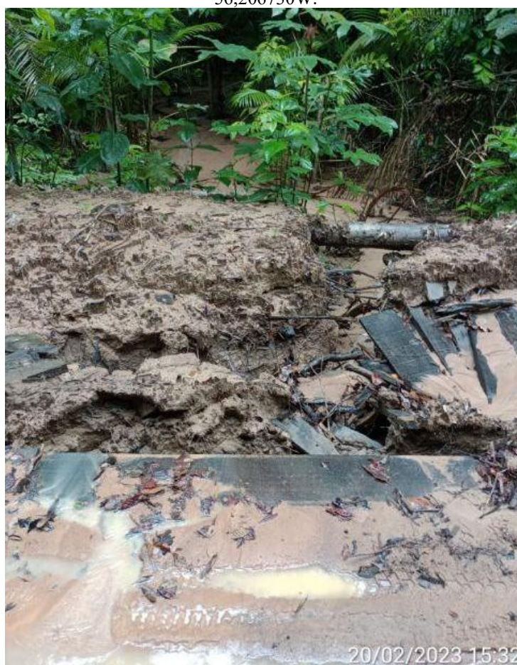
Figura 79 — A partir de um olhar transversal, no sentido do igarapé, observa-se que a estrutura da ponte não se sustenta e cede sobre as águas que drenam, na parte superior da foto. Coordenadas Geográficas: 1,668033S 56,206730W.
