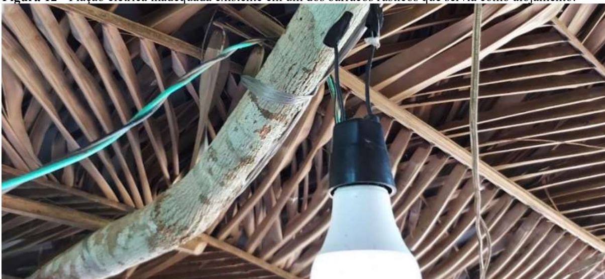
Figura 12 - Fiação elétrica inadequada existente em um dos barracos rústicos que servia como alojamento.
