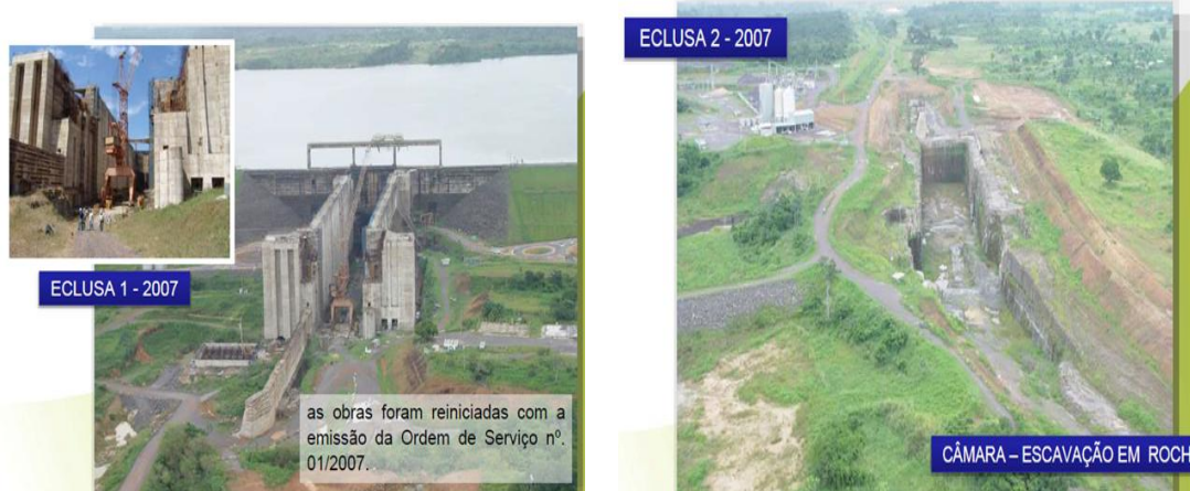
Figura 7 – Retomada das obras do Sistema de Transposição de Desnível, da UHE Tucuruí, em 2007
