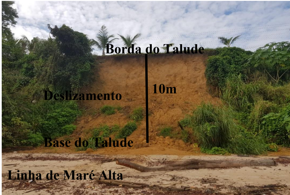
Figura 15: deslizamento na praia de Vila do Conde em Barcarena-PA.
