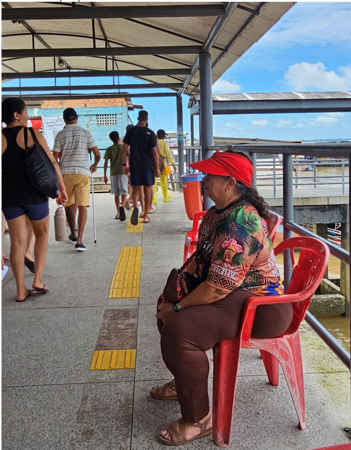
Fotografia 72 – Terminal Hidroviário Ruy Barata, Belém, Pará: a falta de manutenção do piso tátil afeta a rota acessível para pessoas com deficiência visual
