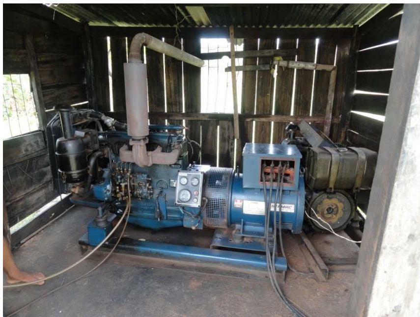
Figura 25 - Gerador elétrico da Vila.
