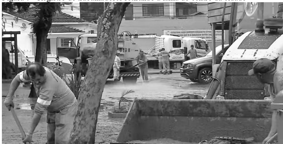
Figura 7 - Registro de trabalhadores retirando a lama do centro da cidade
