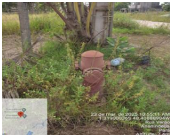
Figuras 22 e 23- Hidrantes funcionais próximos a unidade da COSANPA
