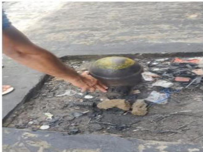
Figura 16 e 17 - Hidrantes não funcionais do Município de Ananindeua-PA
