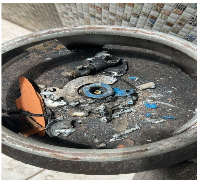
Figuras 10 e 11 – Atendimento a ocorrência de vazamento de gás.
