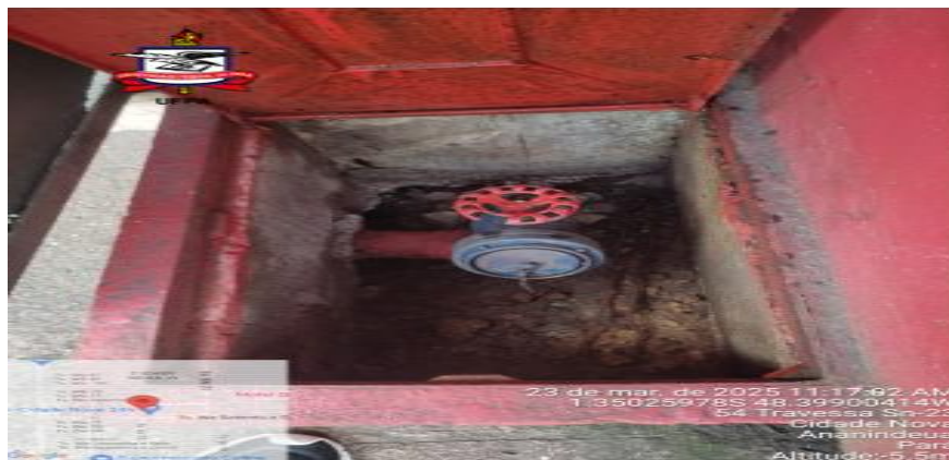
Figura 24 - Hidrante privado funcional
