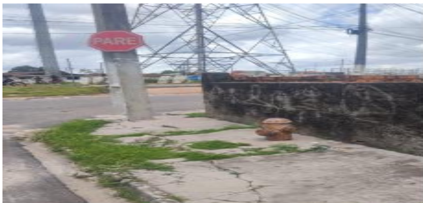
Figura 21 - Hidrante do bairro PAAR não funcional
