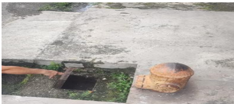
Figura 20 - Hidrante do bairro Curuçambá não funcional
