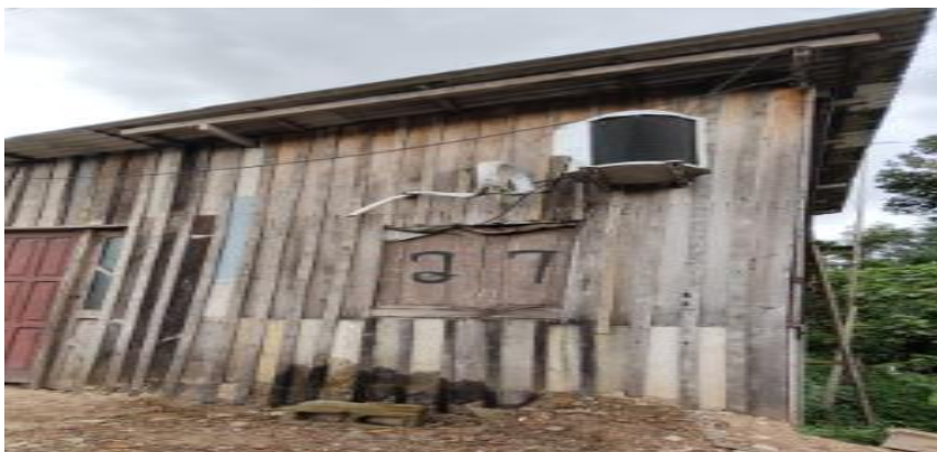
Figura 12 - Instalações elétricas inadequadas
