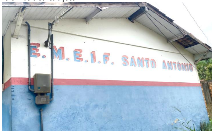
Fotografia 33: Prédio escolar 1 que apresenta necessidades de reformas e construções
