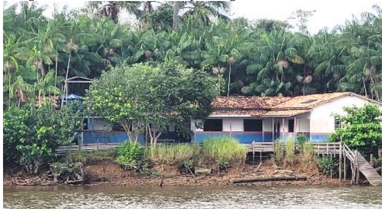
Fotografia 21 – Prédio interditado pelo engenheiro civil da SEMEC
