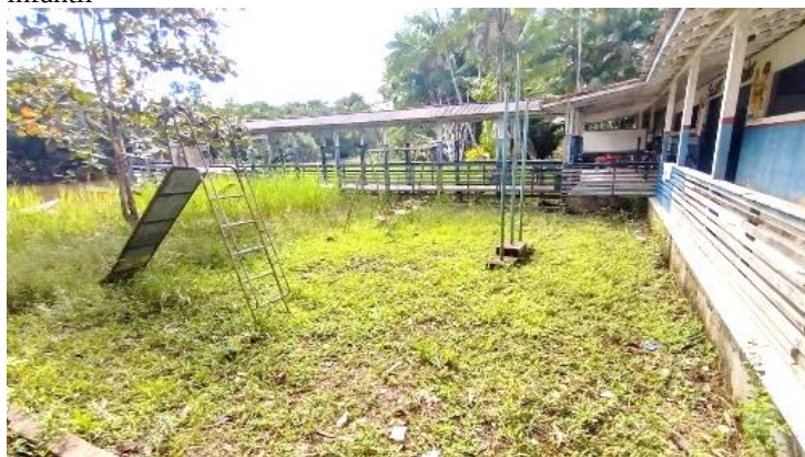
Fotografia 16 – Falta de manutenção da limpeza da área do parque infantil
