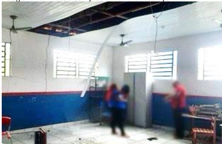
Fotografia 23 – Escola com problemas no telhado e paredes
