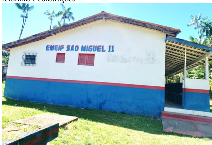
Fotografia 35: Prédio escolar 3 que apresenta necessidades de reformas e construções
