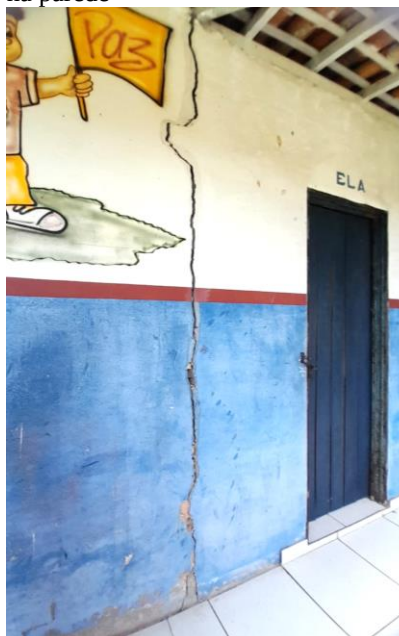
Fotografia 24 – Escola com rachadura na parede
