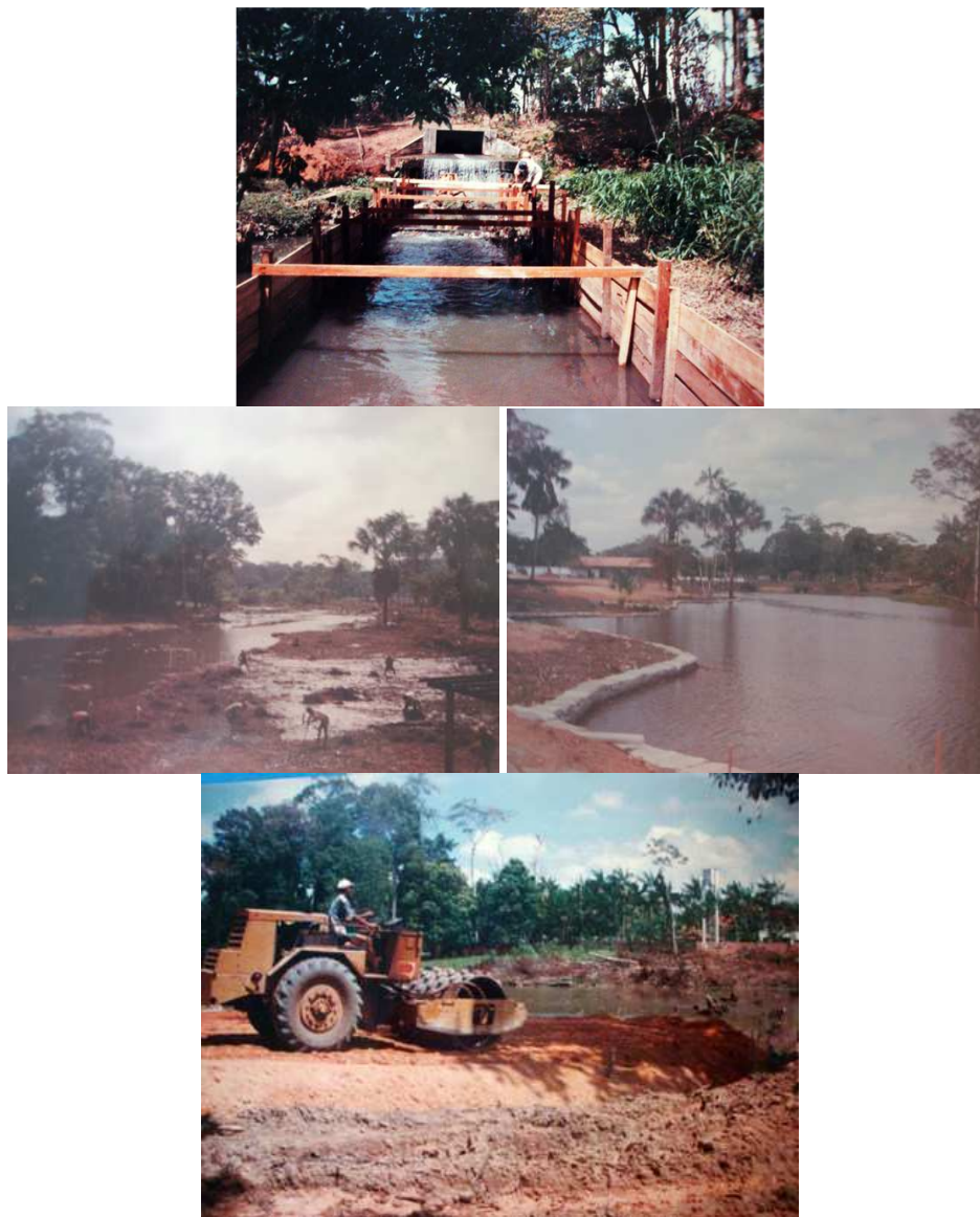
Figura 189- Etapas construção da galeria e da represas na área do residencial Lago Azul. Fonte: Disponibilizado pela diretoria do Condomínio Lago Azul.
