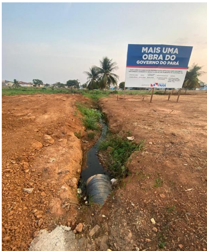
Figura 62: Obra da Lagoa do Independente I com esgoto a céu aberto.
