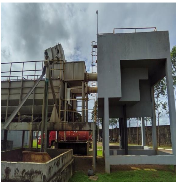
Figura 46: SKID de tratamento preliminar.
