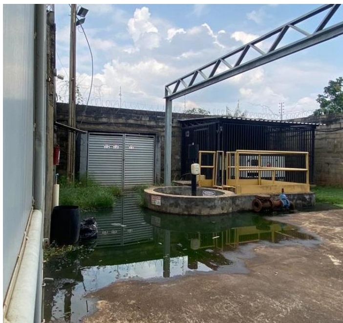
Figura 73: Problema crítico em estação de tratamento de Esgoto do RUC Laranjeiras.
