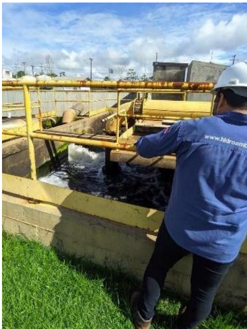
Figura 51: Elevatória de Efluente Tratado.
