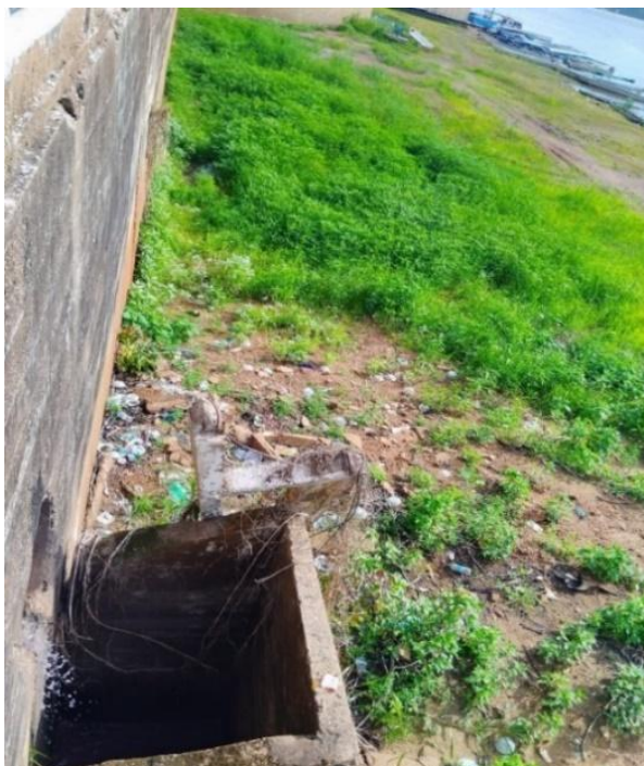
Figura 21: Despejo de esgoto na orla da cidade.
