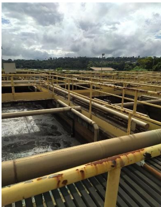
Figura 48: Tanque de Aeração.
