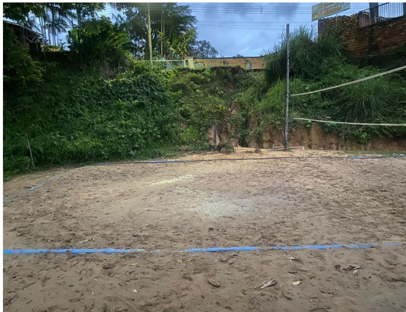
Imagem 08- Mesma área de erosão vista da praia.
