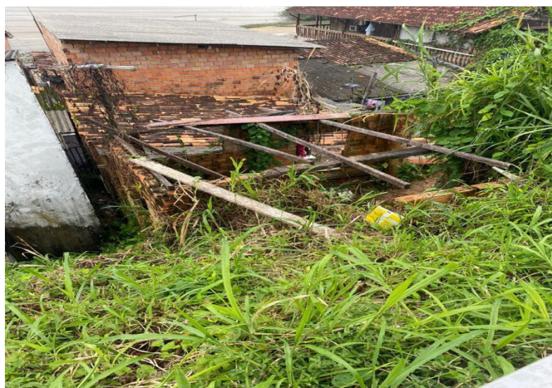
Imagem 09- Casa destruída pela erosão.
