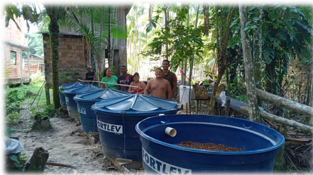
Figura H1 – Vista geral da fossa séptica biodigestora instalada na comunidade ribeirinha Maria Petrolínia do Porto Ceasa.
