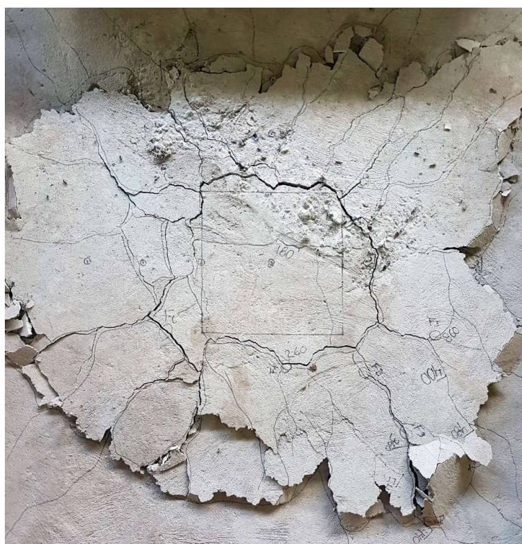
Figura 4.25 – Mapa de Fissuração da laje SW1
