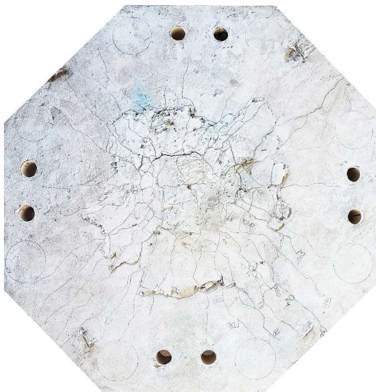
Figura 4.22 – Mapa de Fissuração da laje REF
