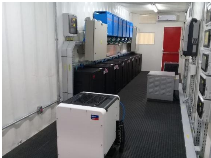
Figura 16 - Banco de baterias instalado nas dependências do CEAMAZON
