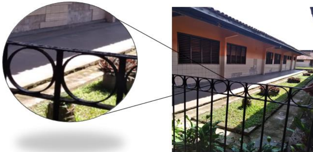
Figura 14 – Detalhe da grade em ferro em processo de oxidação na Escola Dom Calábria.
