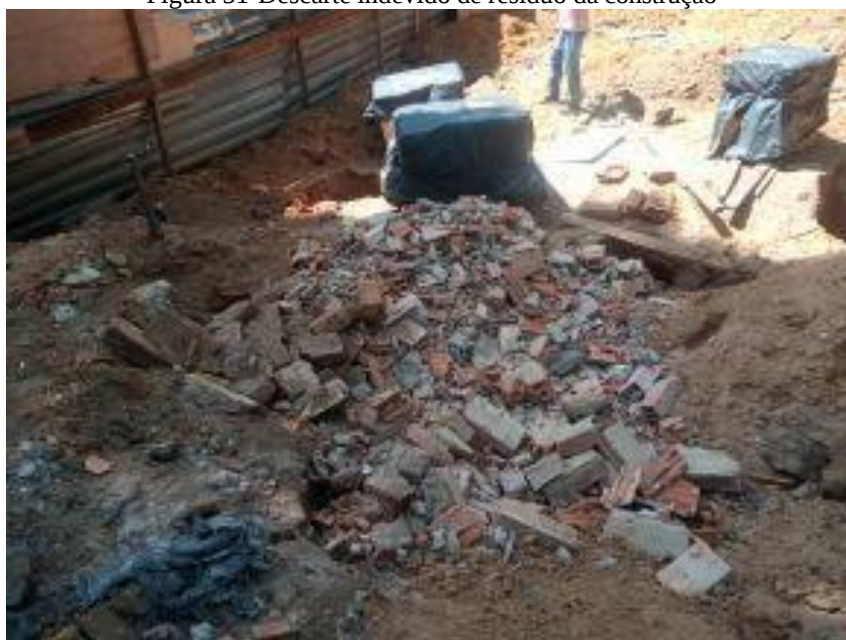
Figura 51-Descarte indevido de resíduo da construção
