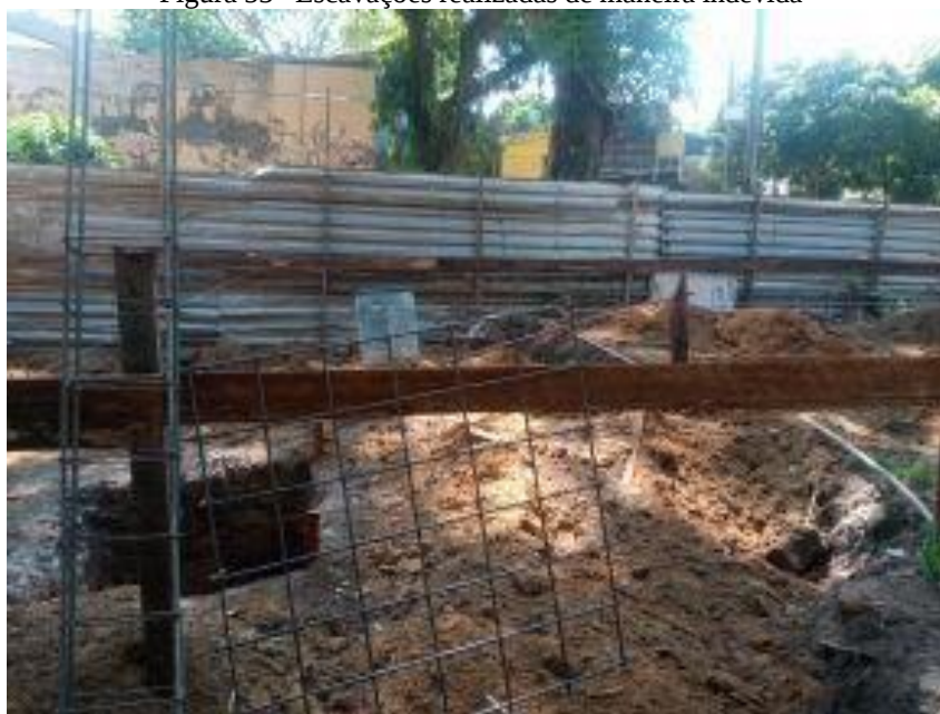
Figura 53– Escavações realizadas de maneira indevida
