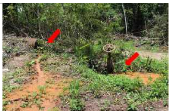
Figura 19 – Ponto de lançamento da tubulação irregular
