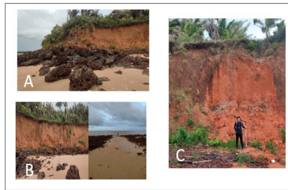
Figura 10. Zona de supramaré da Praia da Baleia com blocos rochosos antigos (A); presença de blocos rochosos na LMA até o LMB (B); ocorrência de processos erosivos na falésia (C).
