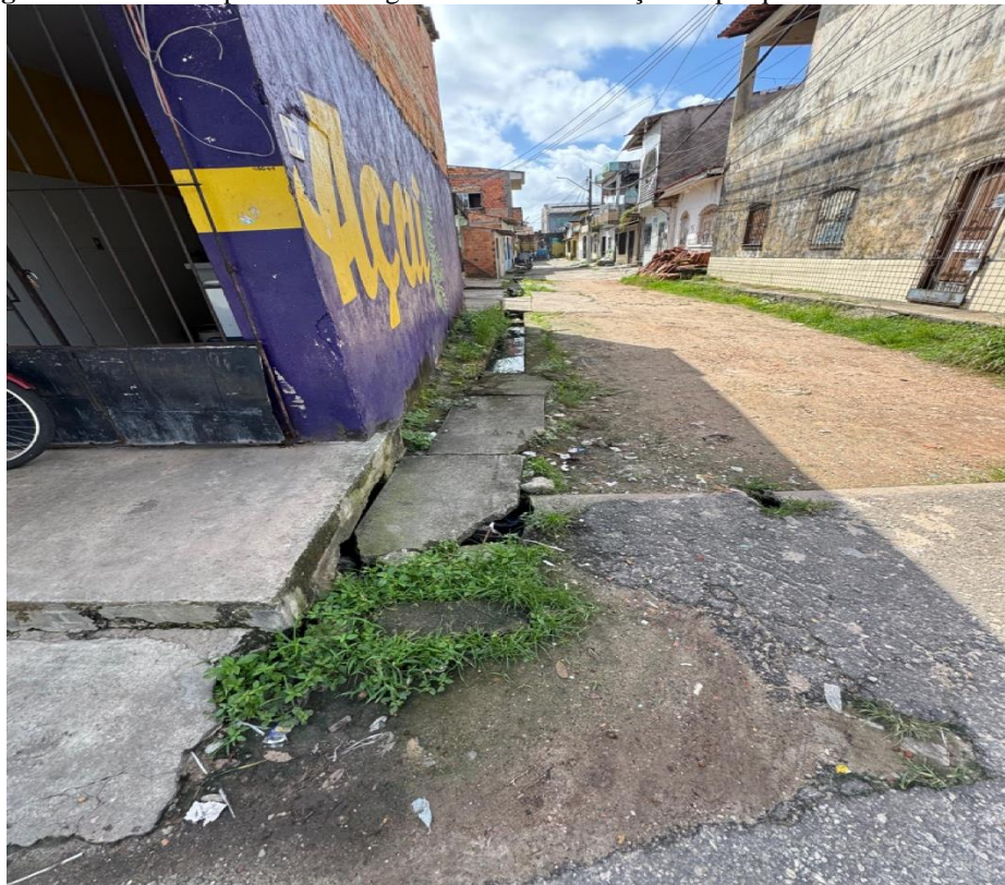
Figura 29 – Sistema precário de esgoto atual na localização da pesquisa
