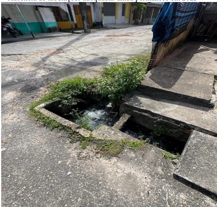
Figura 20 – Ausência de tubulações adequadas ainda permanece em 2025
