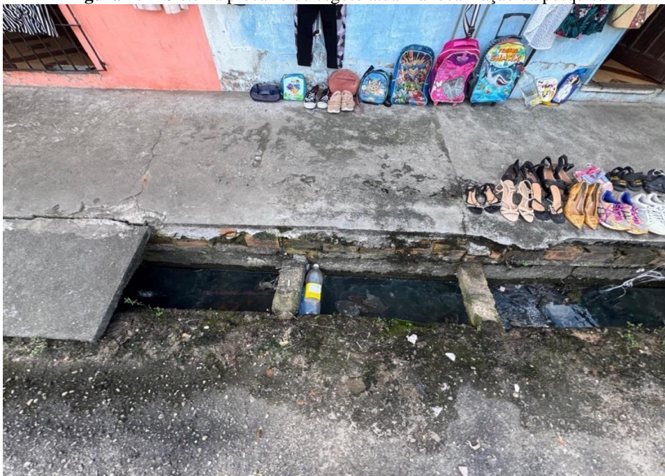
Figura 25 – Sistema precário de esgoto atual na localização da pesquisa
