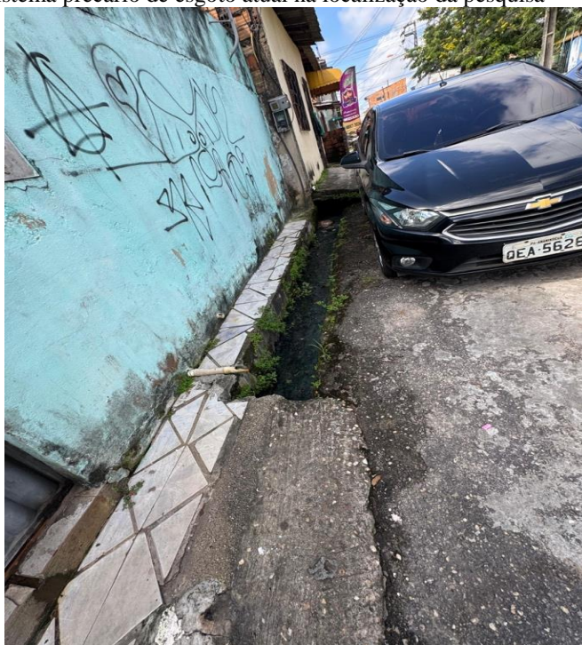
Figura 26 – Sistema precário de esgoto atual na localização da pesquisa
