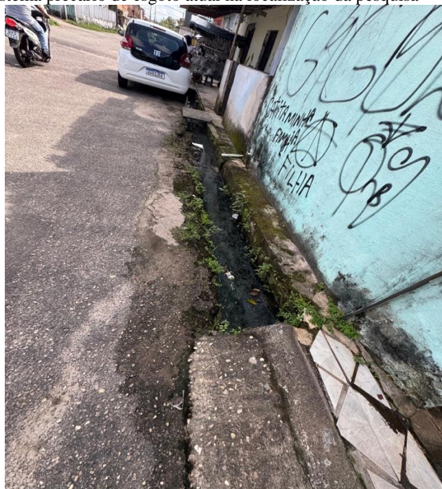
Figura 27 – Sistema precário de esgoto atual na localização da pesquisa
