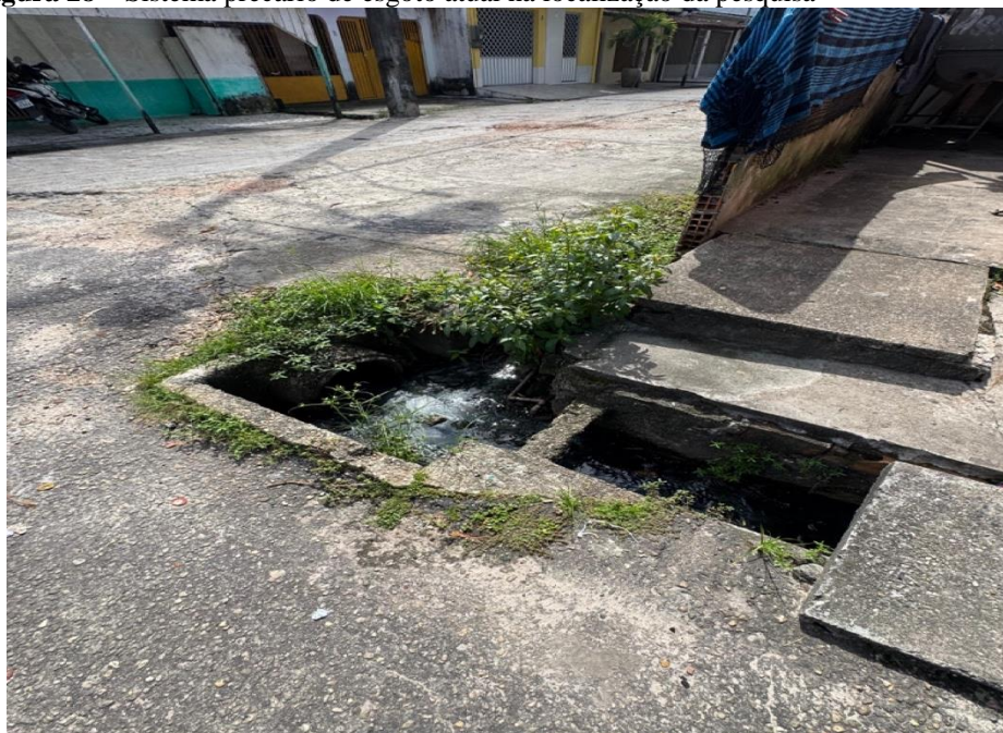
Figura 28 – Sistema precário de esgoto atual na localização da pesquisa
