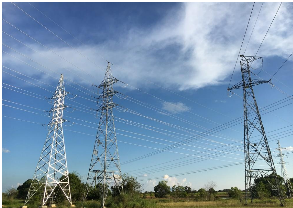
Figura 5 – Torres de transmissão de energia do Linhão de Guri
