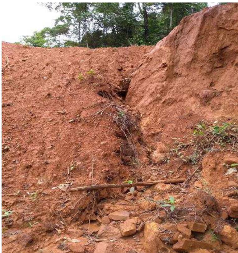
Figura 21 – Abertura na ombreira esquerda da barragem
