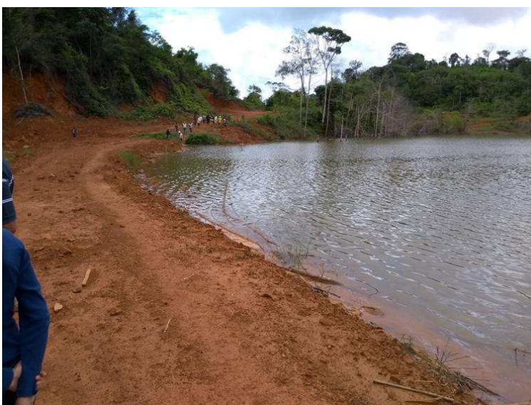
Figura 16 - Barragem de rejeito Laborrie, N.A. próximo ao galgamento em 2018
