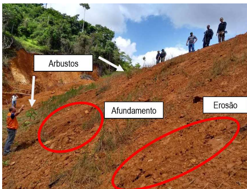
Figura 25 – Deterioração dos taludes
