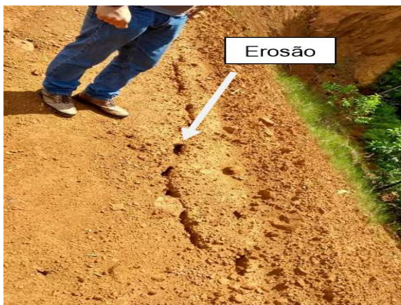
Figura 23 – Erosão e trincas longitudinais
