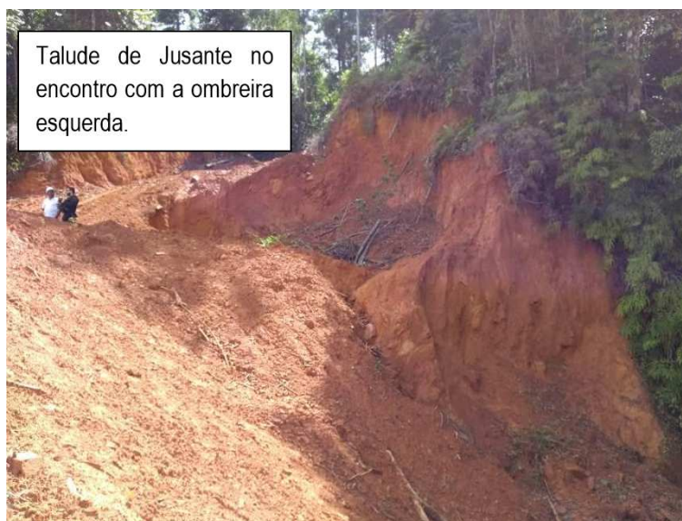
Figura 27 – Erosão no talude
