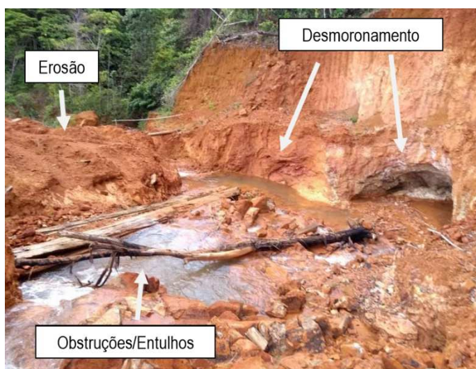
Figura 29 – Erosão próximo ao extravasador 1
