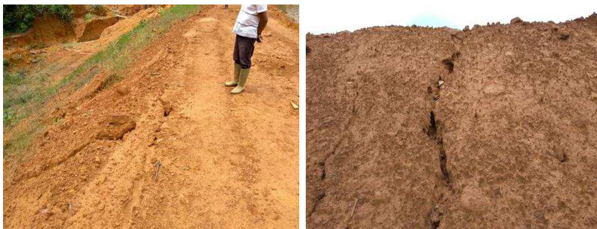
Figura 20 – Processos erosivos ao longo do talude de jusante
