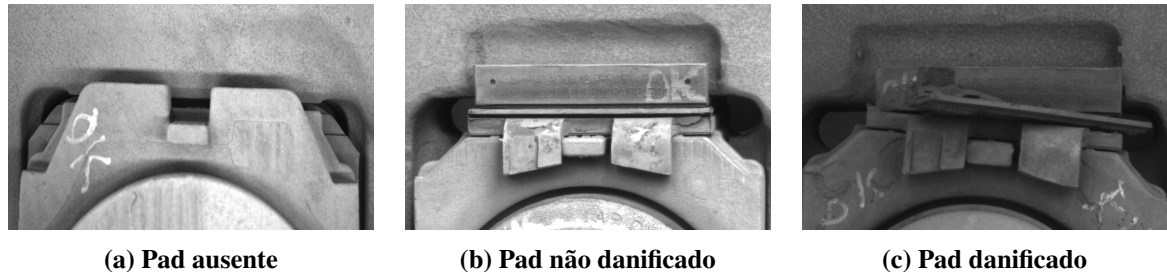
Figura 16 – Três situações que o componente estrutural pad pode ser encontrado. Essas situações caracterizam as três classes de imagens utilizadas neste trabalho, que são: ausente (a), não danificado (b) e danificado (c).
