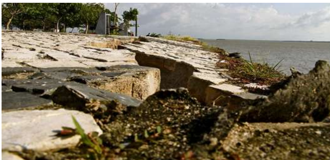
Parte do piso do Portal da Amazônia está desabando (Foto: Wagner Santana)
