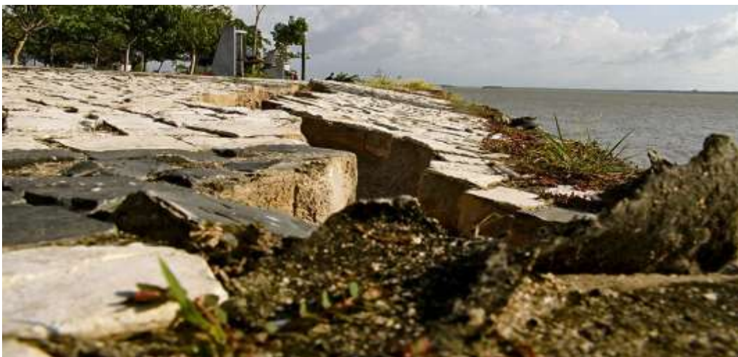
Parte do piso do Portal da Amazônia está desabando (Foto: Wagner Santana)
