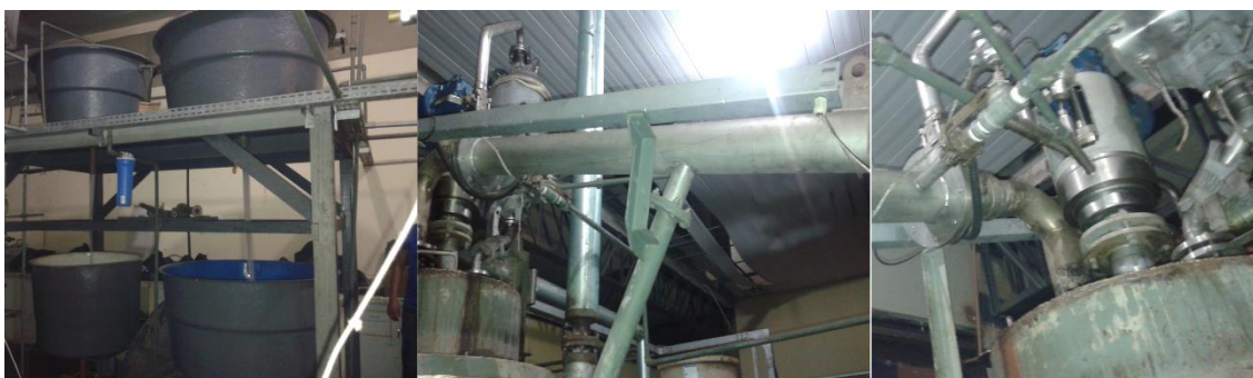
Figura 27: Sistema de resfriamento da planta piloto de craqueamento.
