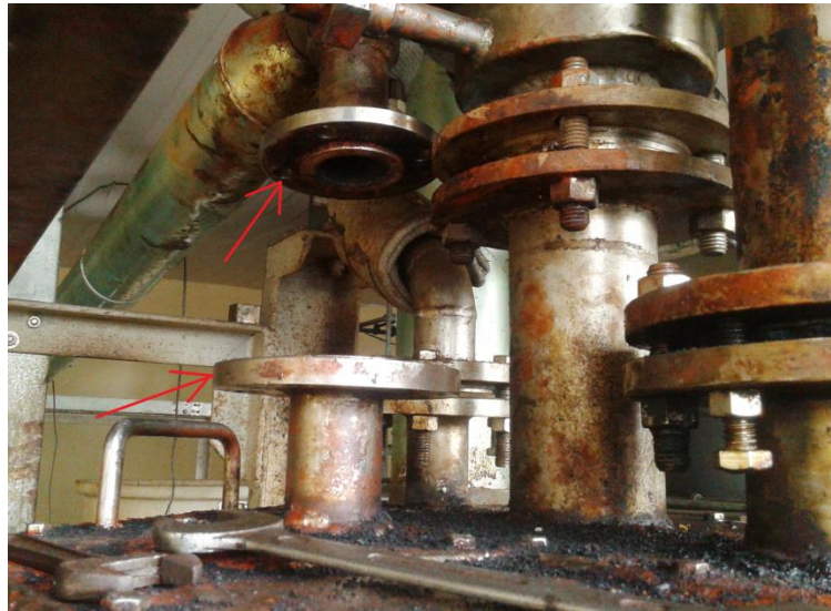
Figura 25: Flange na parte superior do reator (alimentação do reator).
