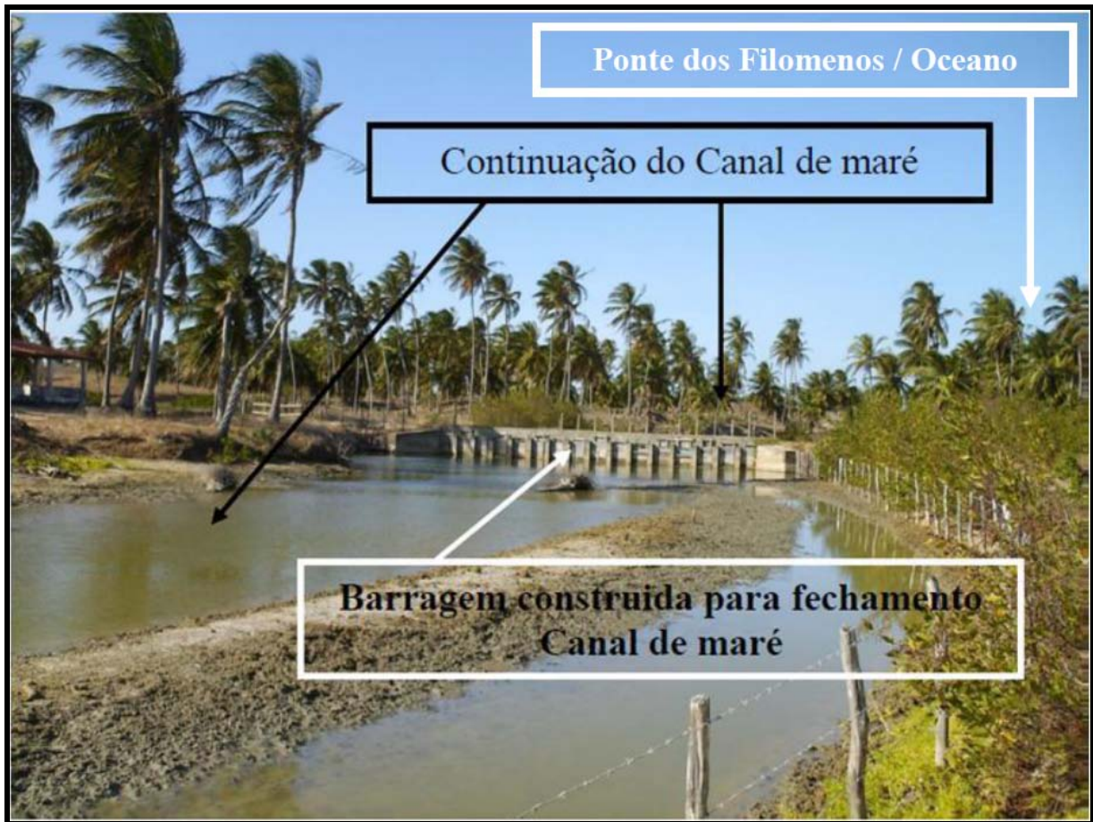
FIGURA 26 – Continuação do canal de maré 1, com detalhe da barragem construída na localidade de Olho d’água, responsável pelo controle tanto da entrada da água do mar na laguna quanto pela saída de águas continentais na época chuvosa, localidade Faísca. Foto: Lamarka Lopes Pereira 11/2007.
