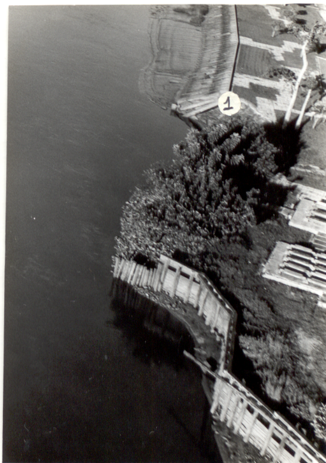
FIG. 27: Erosão progressiva da margem após a construção do novo cais de arrimo. Em ① o limite entre a construção antiga e a atual.
