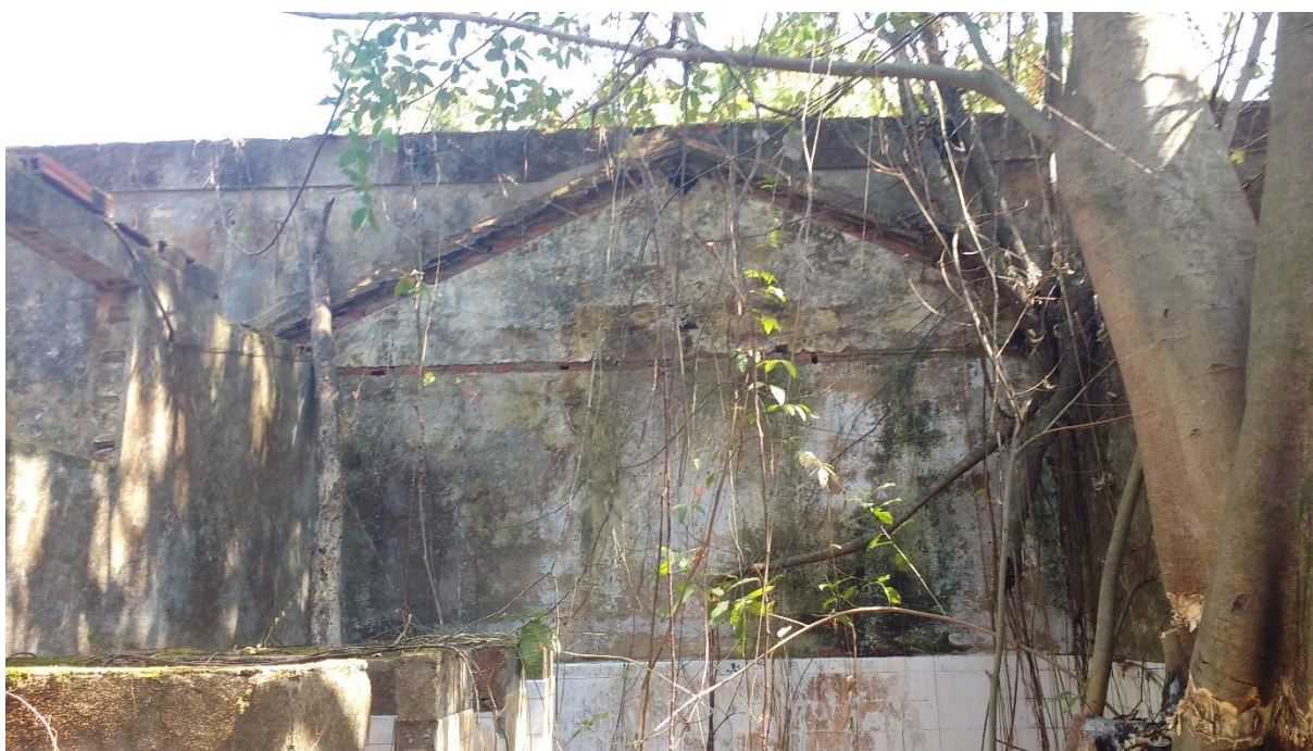
Figura 59: Aumento do pé direito na parede direita do cômodo 4. Foto: Amanda Seabra
