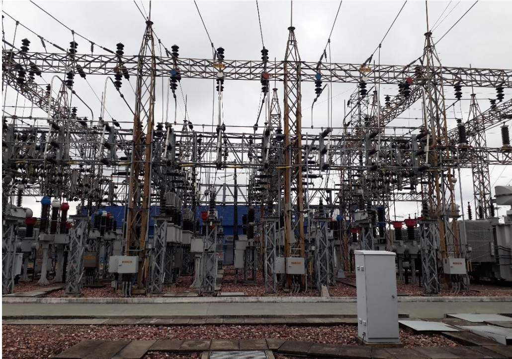
Figura 3.1 - Subestação com suas respectivas linhas de transmissão conectadas no barramento de 69 kV.
