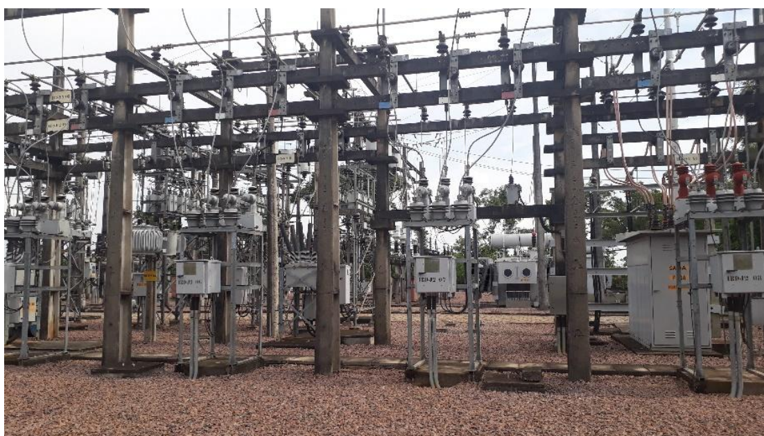
Figura 3.5 - Religadores instalados nas barras de 13,8 kV.
