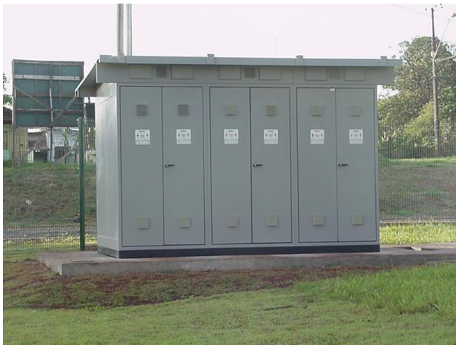
Figura 2.1 - Três cubículos com seus respectivos DJ's 13,8 kV instalados na subestação.
