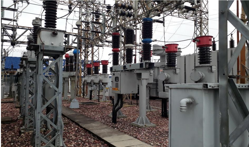
Figura 3.2 - Subestação com os disjuntores, transformadores de correntes/tensão e transformadores de potência instalados no barramento de 69 kV.
