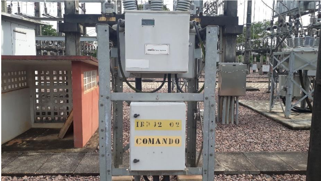
Figura 3.6 - Comando do religador instalado na barra de 13,8 kV.
