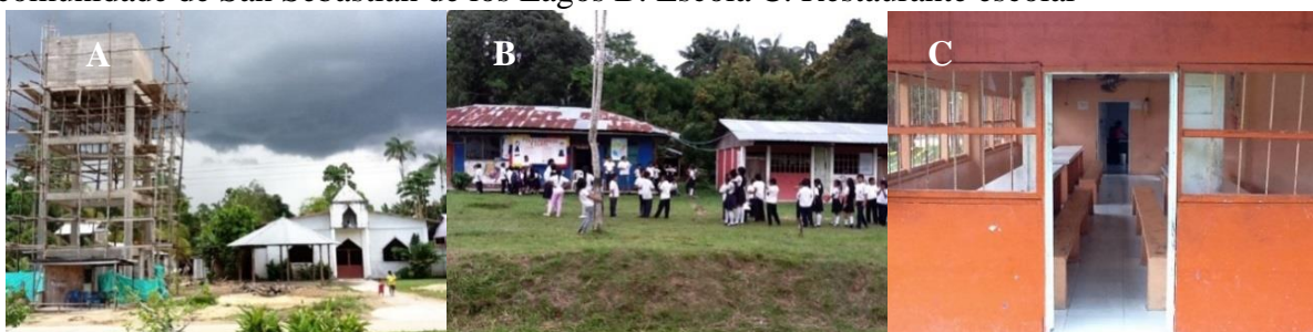
Foto 47 - A. Construção do tanque de armazenamento da água. Sistema de aqueduto da comunidade de San Sebastián de los Lagos B. Escola C. Restaurante escolar
