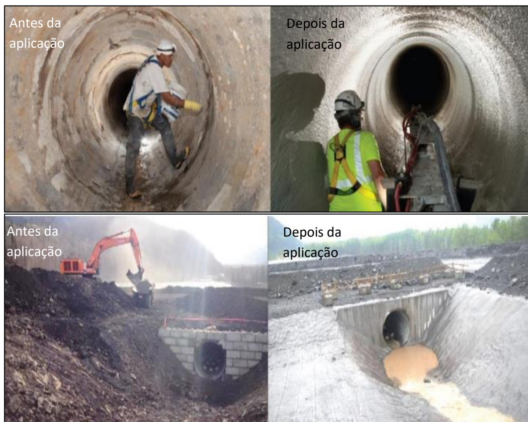
Figura 2.6 - Geopolímero utilizado para revestimento de concretos deteriorados. Fonte: MILLIKEN (2017).
