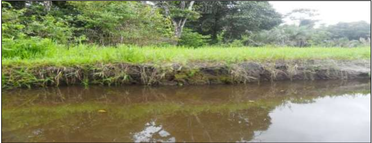
Figura 2 – Erosão as margens do rio Peixe Boi
