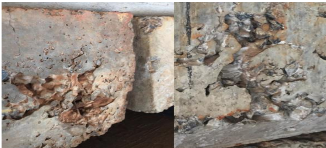
Figura 2.22 - Segregação de material em ponte na BR-020, região de Sobradinho-DF. Fonte: COSTA, 2016.
