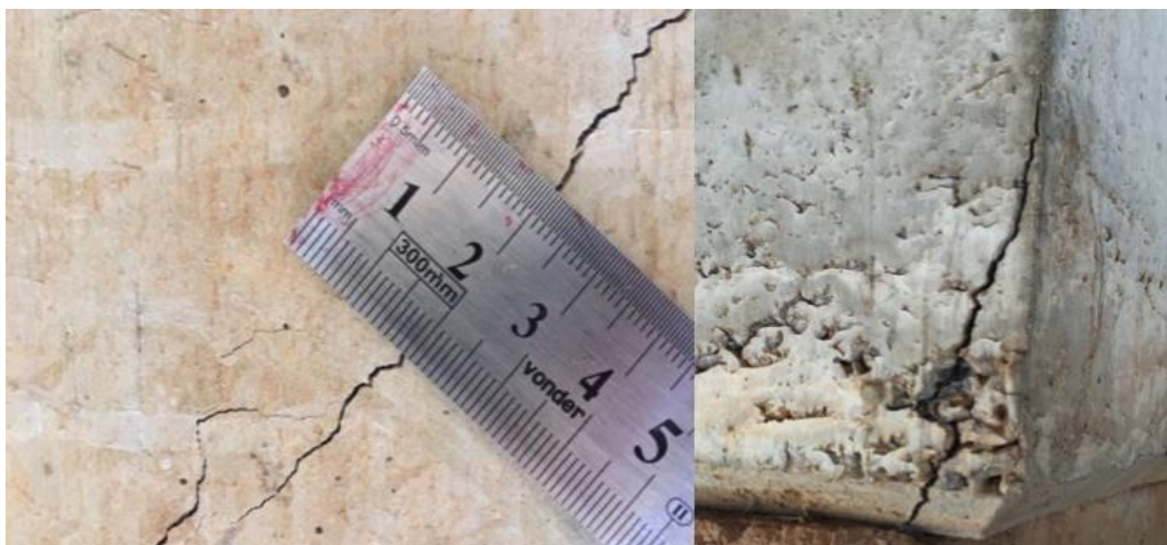
Figura 2.23 - Fissurações em ponte na BR-020, região de Sobradinho-DF. Fonte: COSTA, 2016.
