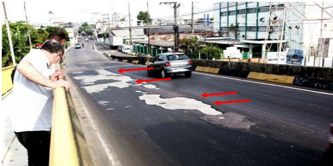
Figura 4.10 - Evidência de formação cavidades no revestimento do pavimento asfáltico.
