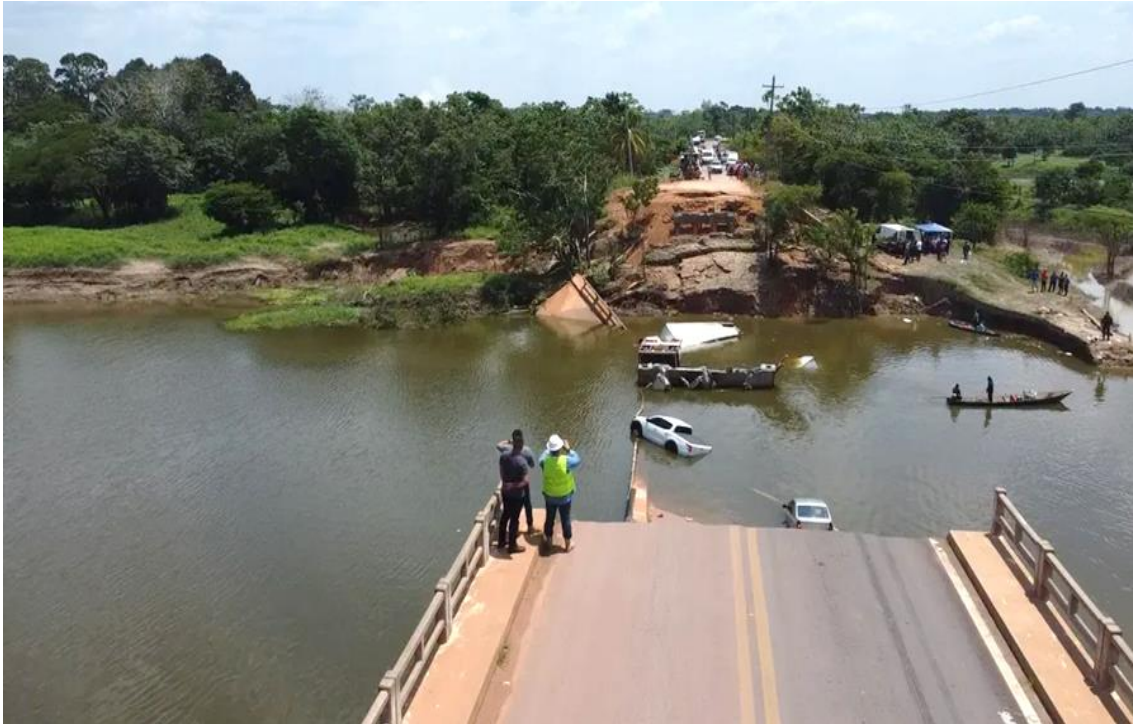
Figura 2.17 - Outro ângulo da ponte que desabou sobre o rio Curuçá, BR-319, AM, em 2022.
