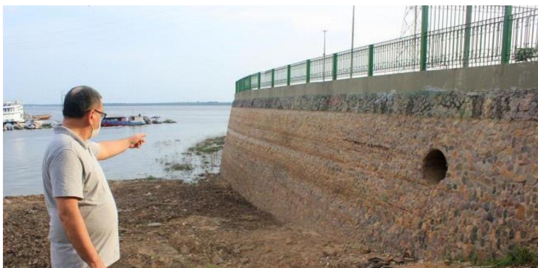
Figura 4.3 - Muro de arrimo em pedras à jusante da ponte, inibe o processo erosivo.
