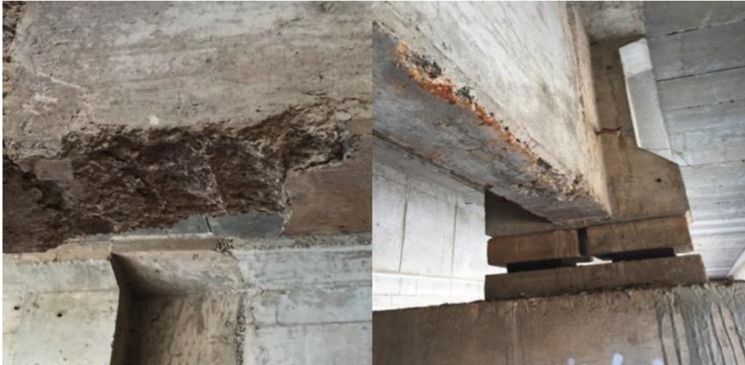
Figura 2.20 - Desagregações em ponte na BR-020, região de Sobradinho-DF. Fonte: COSTA, 2016.
