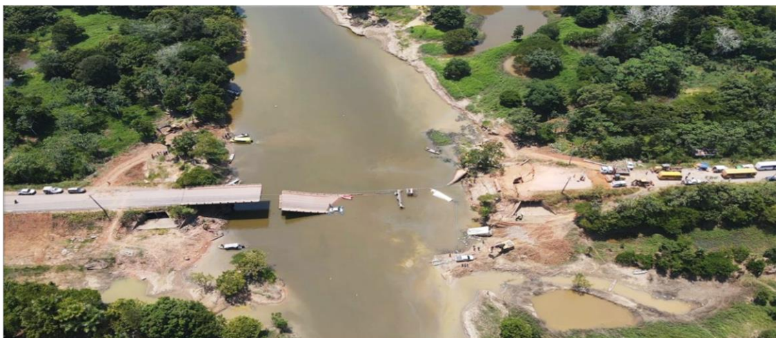
Figura 2.16 - Desabamento ponte - rio Curuçá, BR-319, AM - em 2022, com vítimas fatais.
