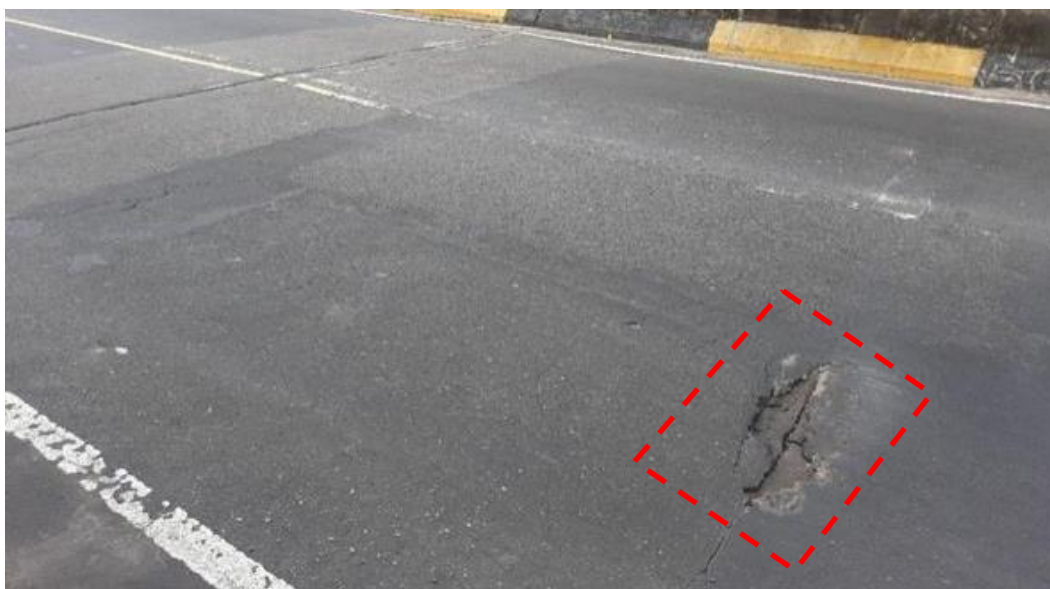
Figura 4.14 - Formação de buraco no pavimento asfáltico.
