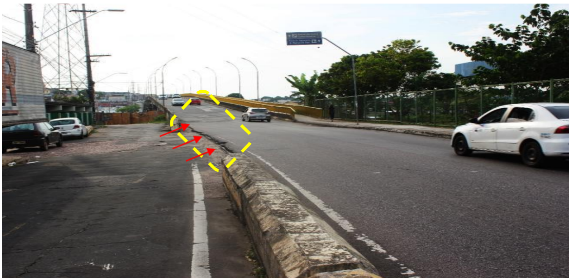
Figura 4.2 - Vista sentido centro-bairro, descontinuidade da barreira em concreto.
