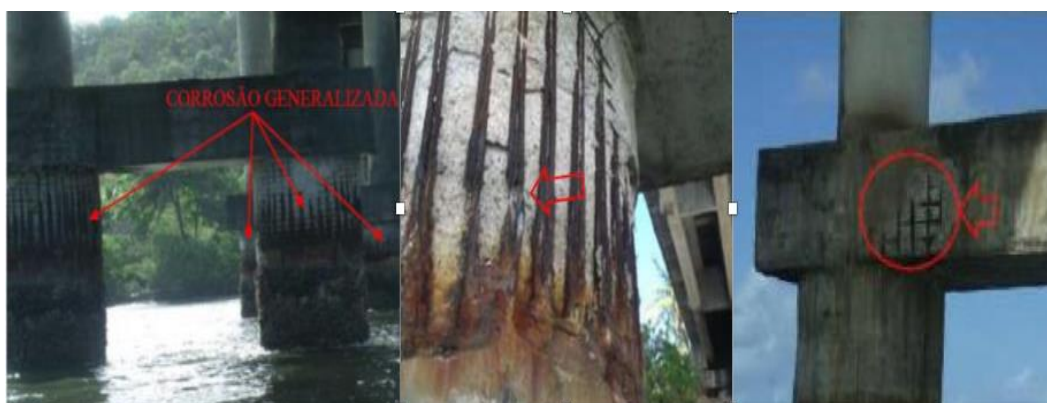
Figura 2.19 - Corrosão da armadura e cobrimento insuficiente na ponte sobre a Laguna do Roteiro-AL. Fonte: SILVA, 2018.
