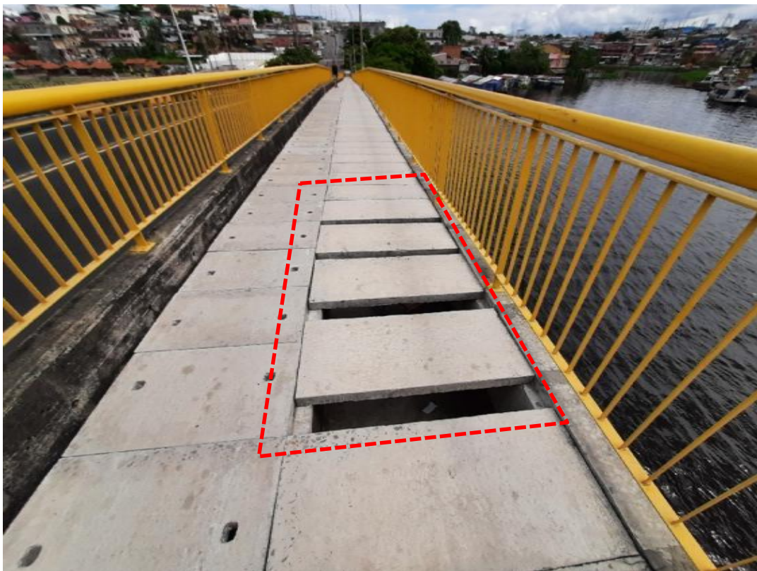
Figura 4.15 - Espaçamento inadequado no piso da passagem de pedestres.
