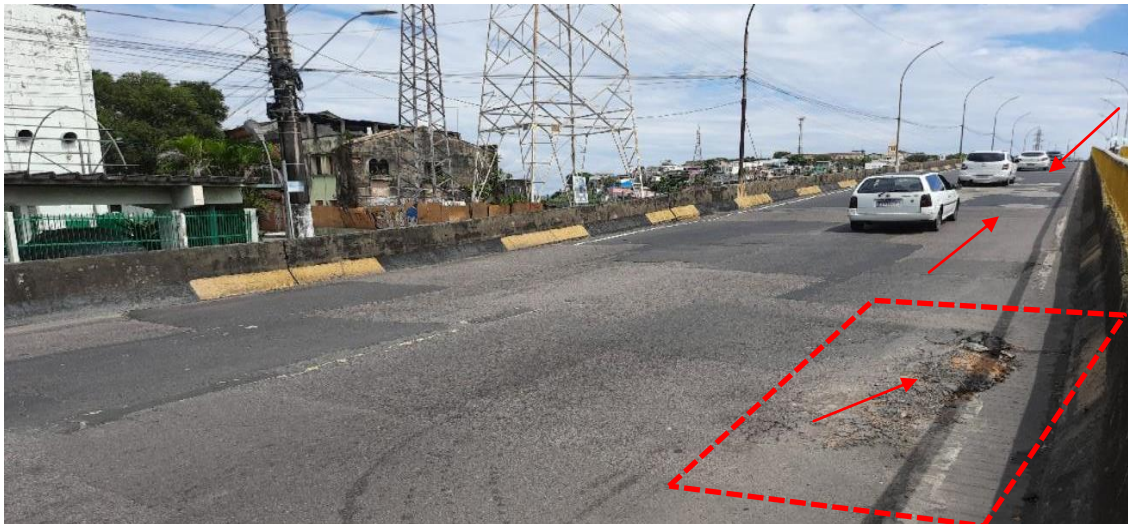
Figura 4.9 - Degradação da camada asfáltica em diversas partes da pista.
