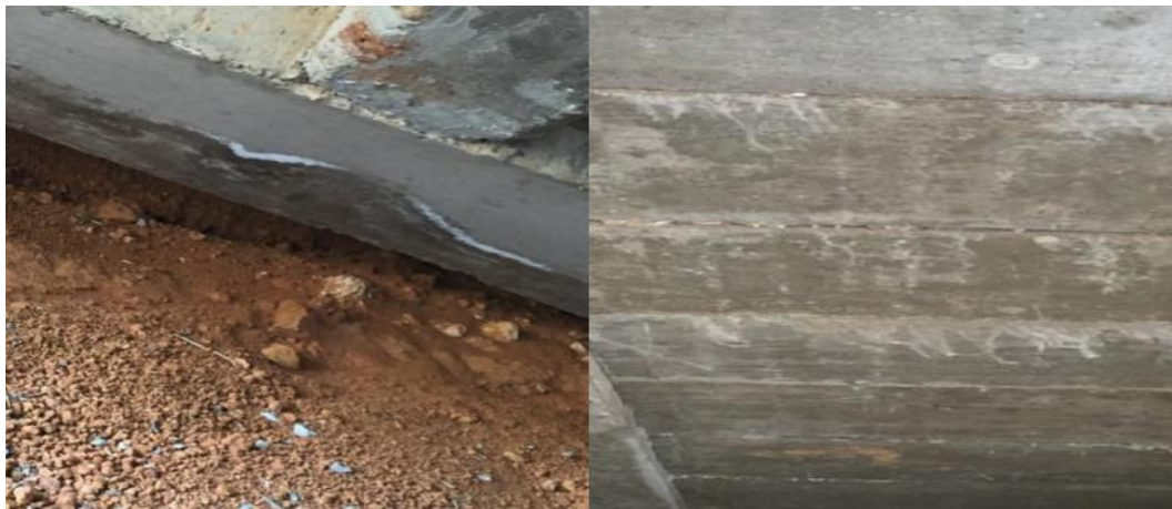
Figura 2.21 - Lixiviação/eflorescências em ponte na BR-020, região de Sobradinho-DF. Fonte: COSTA, 2016.
