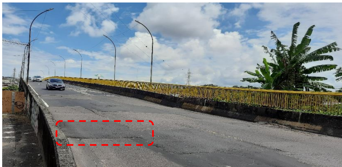
Figura 4.8 - Desnivelamento da pista por problema na capa de asfalto.
