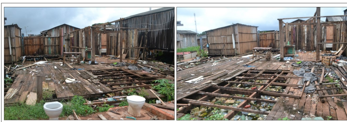
Figura 20 - Demolição de casas na Lagoa do Independente I (16 de maio de 2019) Fonte: Estronioli/Arquivo do Movimento dos Atingidos por Barragens (MAB)
