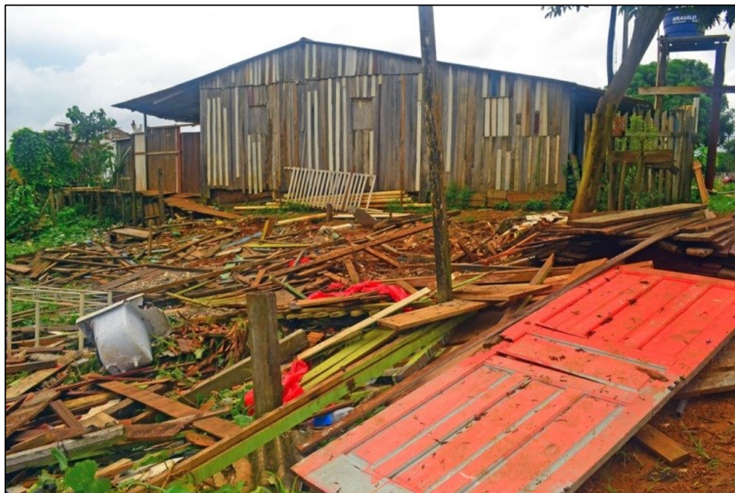
Figura 3 - Casas demolidas por Belo Monte no bairro Boa Esperança (Igarapé Ambé) em 25/01/2015. Fonte: Estronioli/Arquivo do Movimento dos Atingidos por Barragens (MAB)
