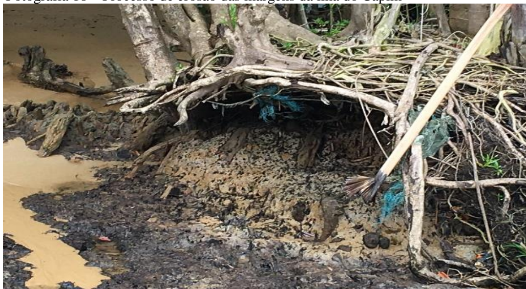
Fotografia 16 – Processo de erosão das margens da ilha do Capim
