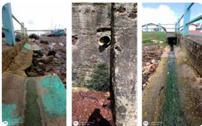
Figura 3 - Esgoto sem tratamento, lançado em área de mangue
