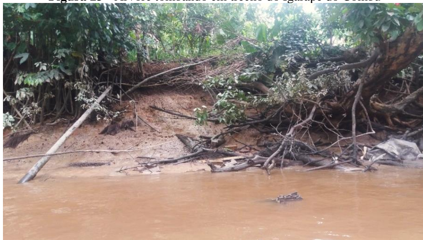
Figura 23 - Árvore tombando em trecho do Igarapé do Combu
