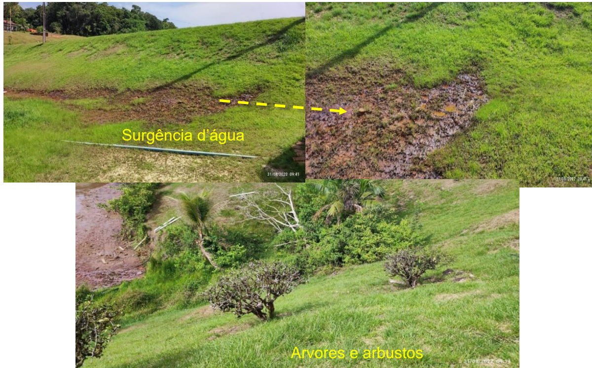
Figura 19 – Anomalias no talude de jusante – Barragem Igarapé Sete Voltas/PA
