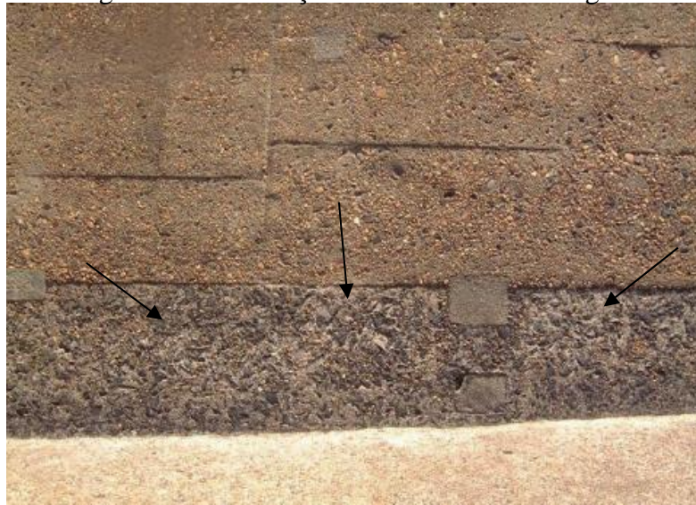
Figura 04 – Lixiviação do concreto em barragem
