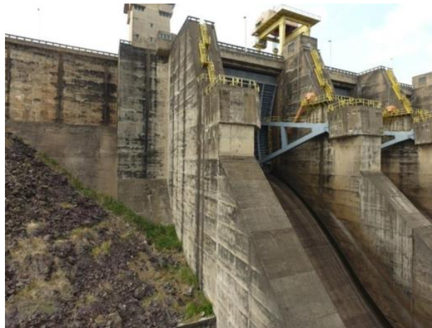
Fig. 17 Acumulação de vegetação junto ao talude de jusante da barragem.
