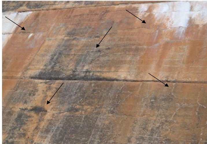
Figura 02 – Trincas no maciço da barragem
