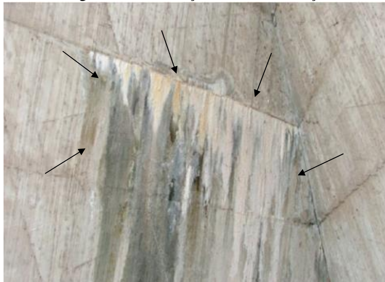
Figura 01 – Infiltração com carbonatação
