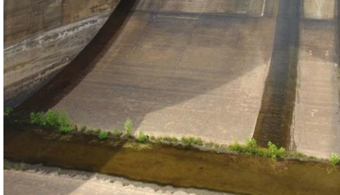
Fig. 11 Presença de vegetação no vertedouro.
