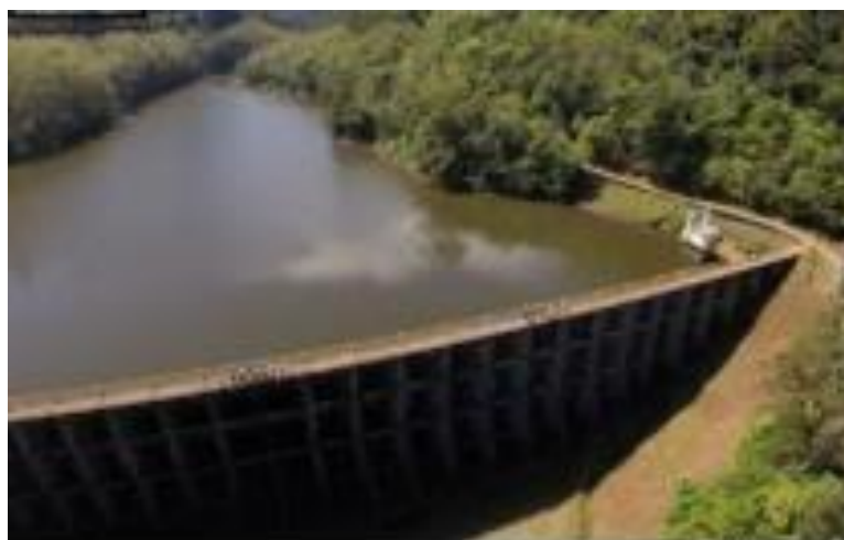
Figura 09 - Detalhes dos contrafortes da ombreira esquerda, em fotografia obtida a partir do uso de um VANT
