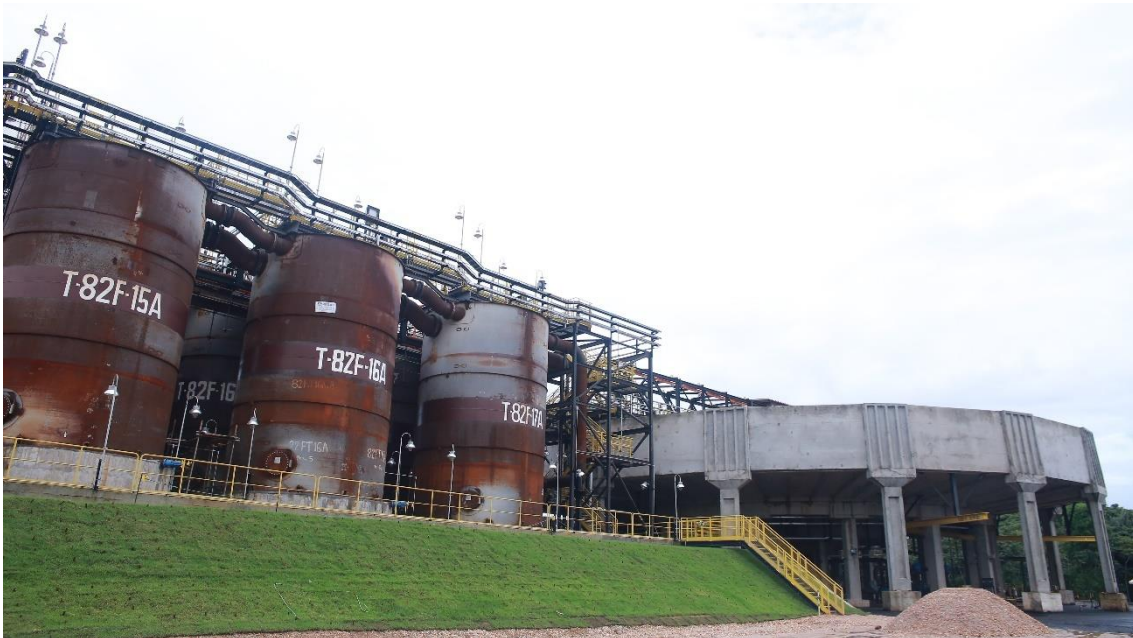
Figura 3 - Tanques de Neutralizadores da ETEI, localizado em Barcarena-Pa.
