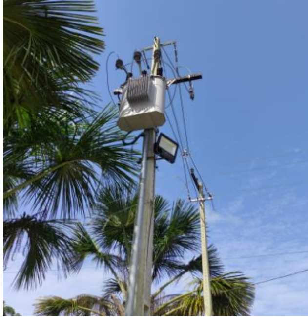
Fig. 6.7 Subestação de 112,5 kVA.
