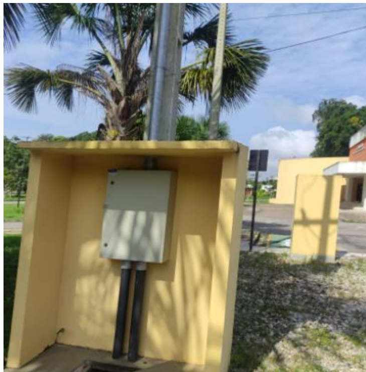
Fig 6.8 Quadro de força dos eletropostos.
