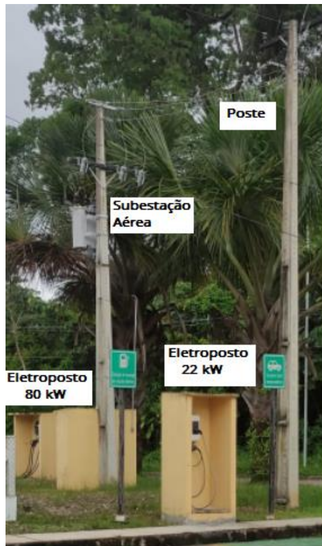
Fig. 6.14. Subestação aérea e poste servem como captores, criando uma zona de proteção contra descargas atmosféricas diretas aos eletropostos próximos.
