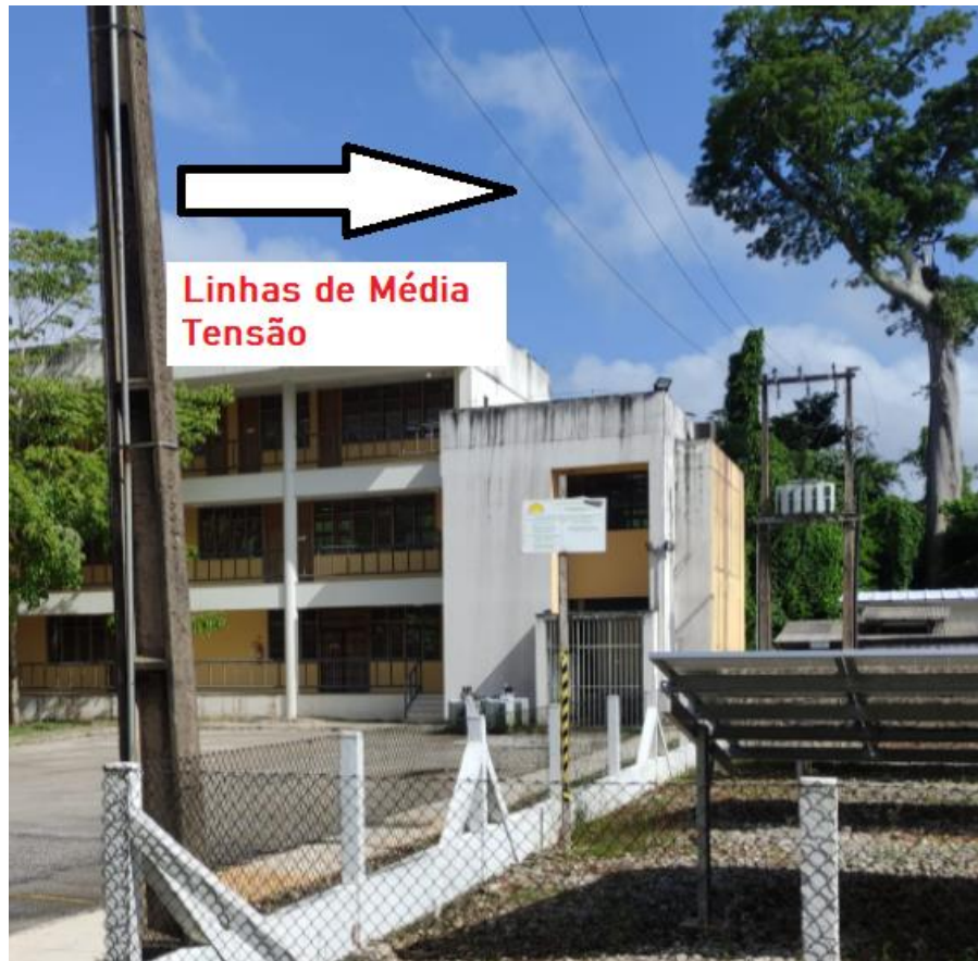
Fig. 6.9 Linhas de transmissão em média tensão.
