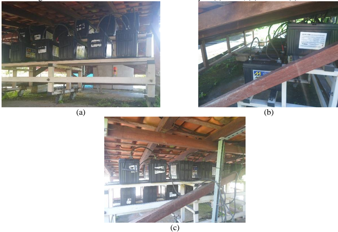
Figura 2.4 - Bancos de baterias no local de instalação: (a) frente, (b) lateral e (c) costa.
