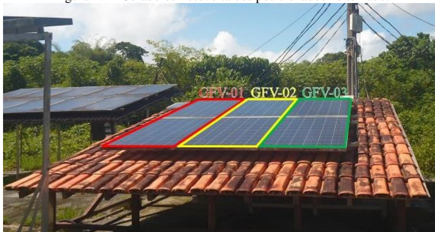
Figura 2.2 - Geradores Fotovoltaicos posicionados no telhado.
