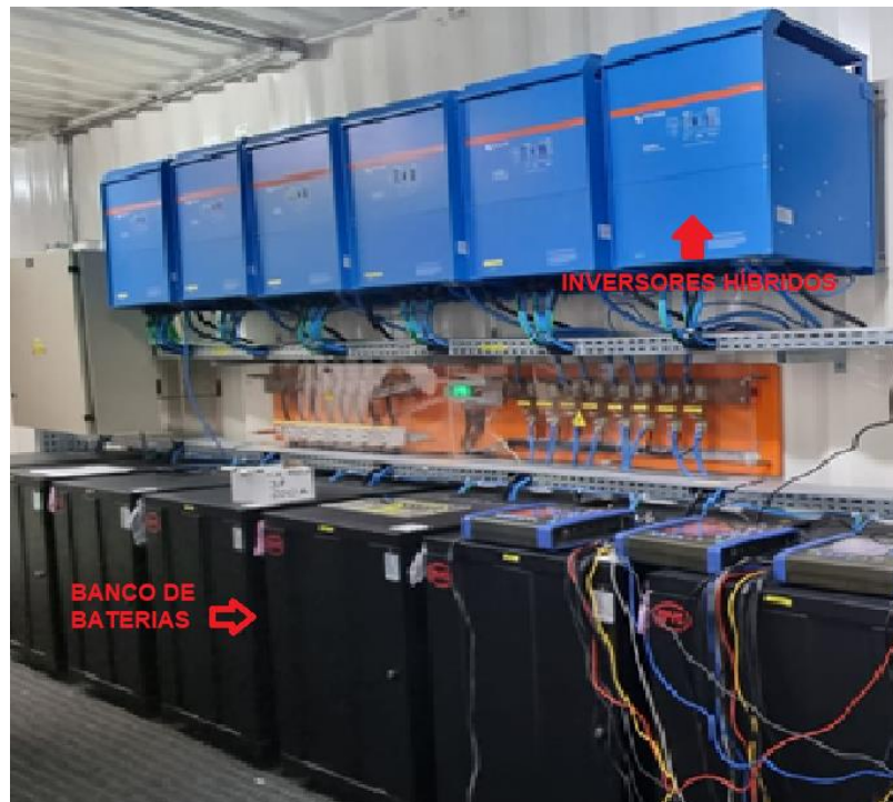
Figura 29 – Configuração banco de baterias e inversores híbridos SIMA
