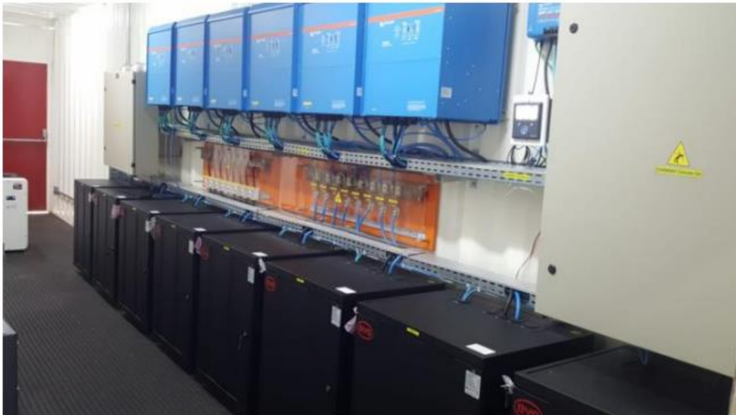
Figura 22 – Sistema de armazenamento de energia, inversores híbridos e baterias
