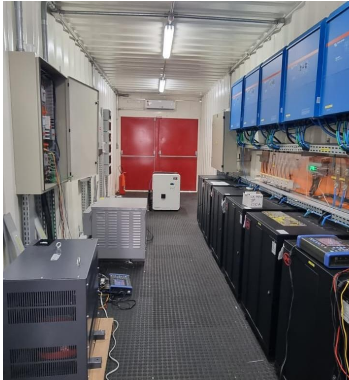
Figura 21 – Estrutura interna do eletrocentro
